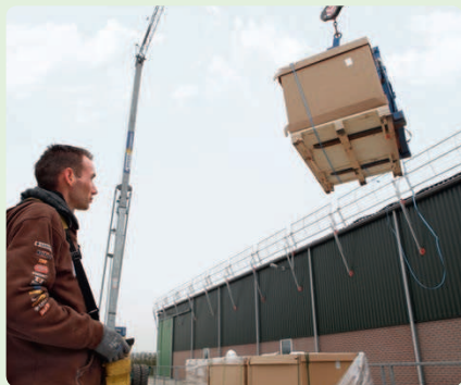
De zonnepanelen worden met een op afstand bestuurbare kraan op het dak ghesen. Daar worden ze op een metalen frame bevestigd.
