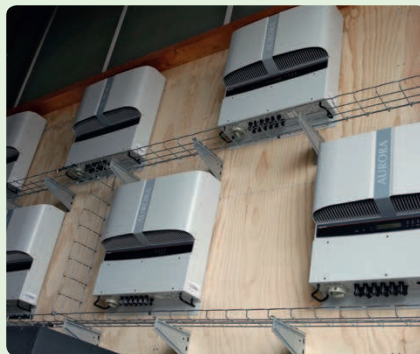
De omvormers - die gelijkstroom omzetten naar wisselstroom - zijn het meest gevoelige onderdeel van de installatie.
